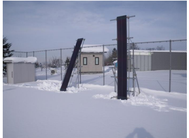
図1 太陽光発電パネルの設置状況
