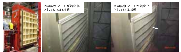
不適切な施工による外装材の膨れの様子（写真右）
