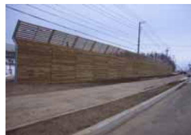
写真 3 木製高性能防雪柵(石狩市)
