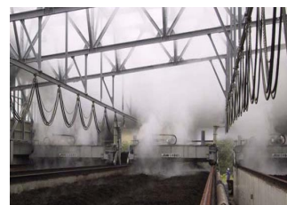
水平発酵槽と自走式攪拌機
