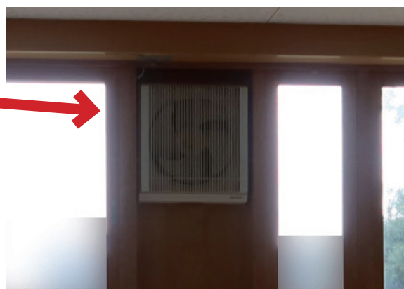
写真2 教室の壁付け換気扇
