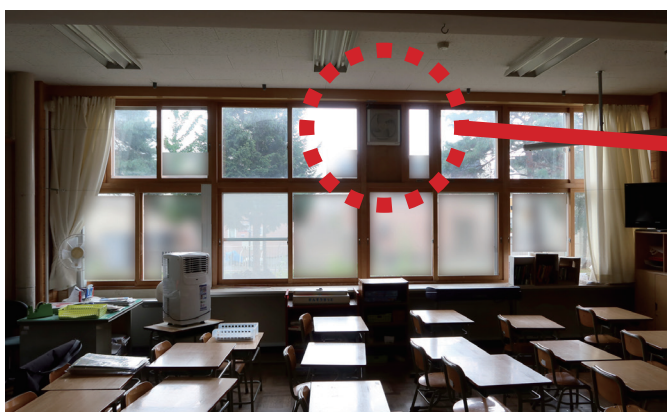
写真1 教室の壁付け換気扇
