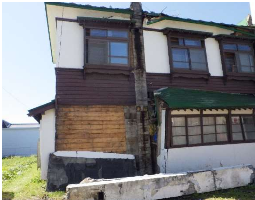
写真 7-1 地震による煙突転倒被害
