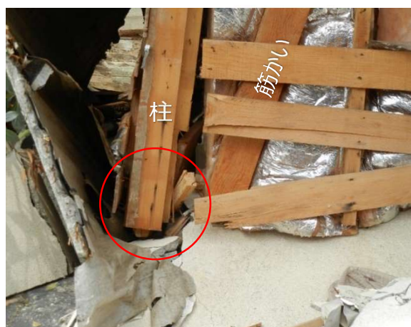
写真 4-2 柱の引き抜け事例
