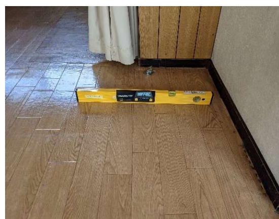
写真 4-5 劣化の確認(床の傾斜)
