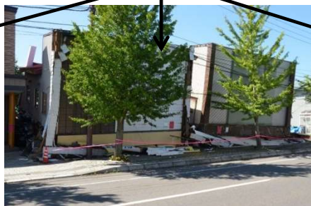
1 階の圧壊（店舗併用）
