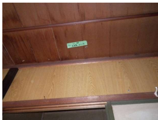
写真 4-1 劣化の確認(天井の水浸み)
