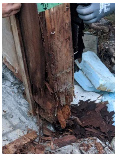
写真 4-4 劣化の確認(躯体の腐食)
