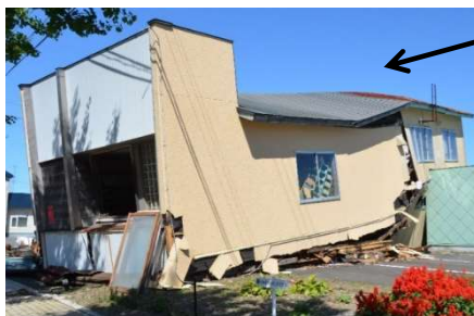
1 階の圧壊（店舗併用）
