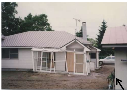
住宅の不同沈下
