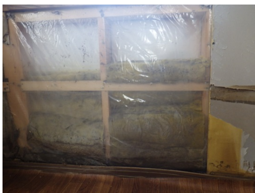
浸水による断熱材のずり下がり
