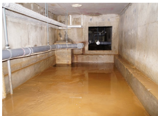
汚泥と水がたまって床下空間が湿潤状態となった床下
