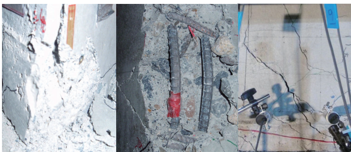
図5 尖端部分の圧壊や付着割裂破壊など
