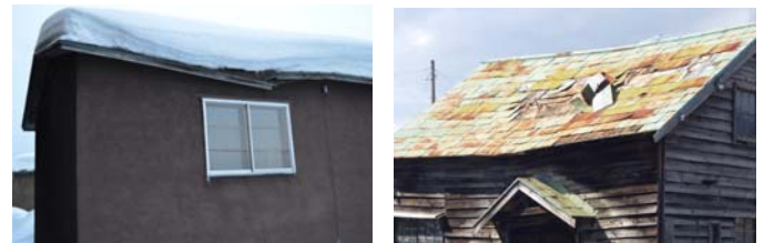
図2 空き家の被害例
