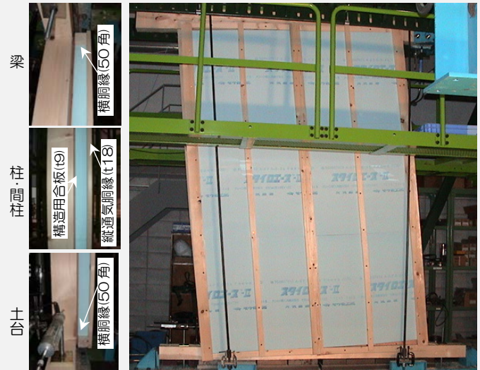
※接合具：構造用面材-CN50@150、 横・縦通気胴縁-「バ」初ド P6-120」または「X-ホ」初ド入 6.0×130」 使用した断熱材：XPS3種、EXS特号、PF1種2号、PUF2種2号
