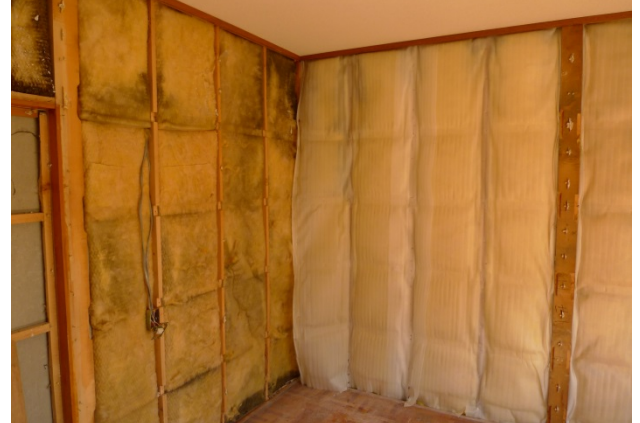
写真1 グラスウール採取現場の例（昭和53年築） 黒く変色した部分は、壁内気流による付着物と考えられ、分析によりカビではないことを確認している。
