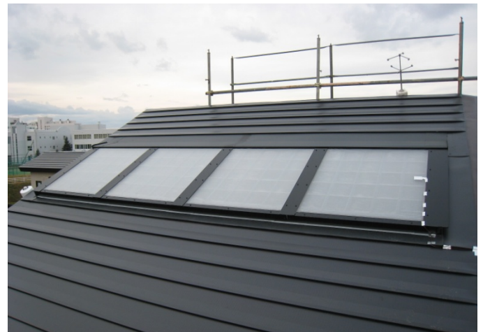
写真1 北総研実験棟に搭載した集熱器
