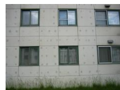
(b) アンカ箇所損傷
