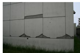
(a) 下地材の損傷
