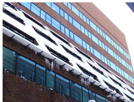
写真1 外壁における積雪と氷柱の発生
