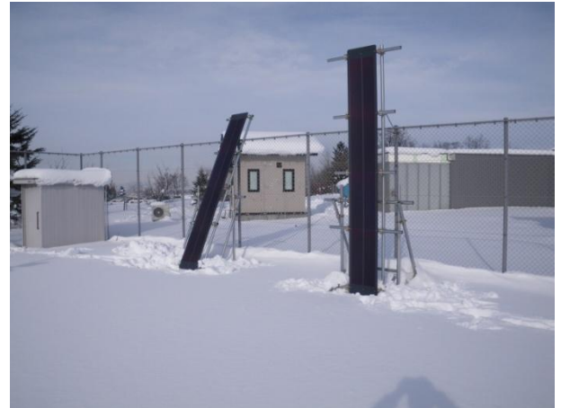
図1 太陽光発電パネルの設置状況
