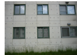
(b) アンカ箇所損傷
