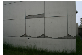
(a) 下地材の損傷
