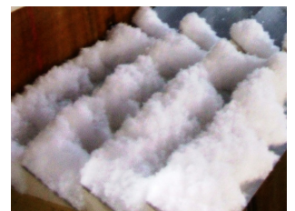
写真2 庇上の堆積状況
