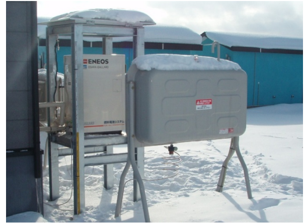
写真1 屋外設置の燃料電池
