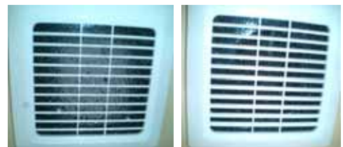
測定開始時 約150日後 室内排気グリルフィルター
