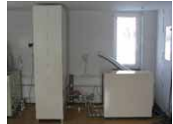
図2 設置した燃料電池システム
