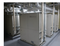
地中熱ヒートポンプ
