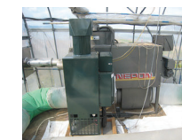
パイプハウス内 環境制御機器
