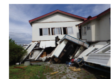
1階部の層崩壊
