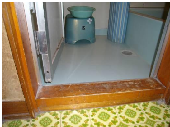
写真6 脱衣室と浴室の段差
