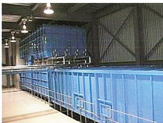
風洞のリターンダクト(上部洞)と冷凍機
