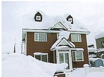
屋根窓で落雪が妨げられている住宅
