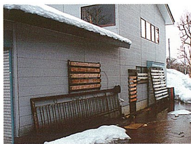
雪から窓を守るための板
