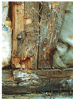
結露が原因で腐った土台と柱
