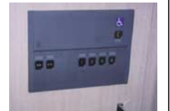
エレベーターのスイッチ
