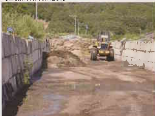
写真2 バンカーサイロ 側壁はコンクリートブロック(廃棄生コンを活用して製作)
