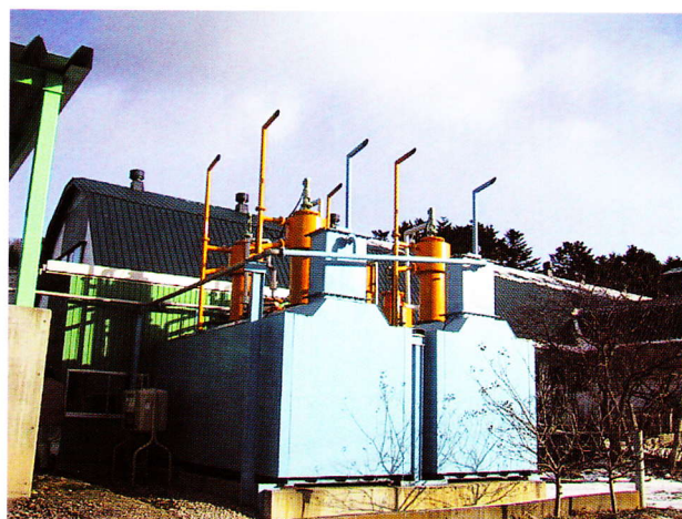
写真 二槽式曝気槽
