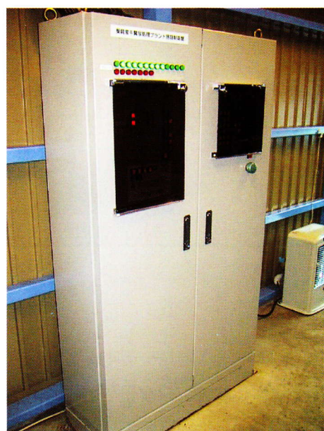
写真 液分移送・曝気処理を制御する制御盤
