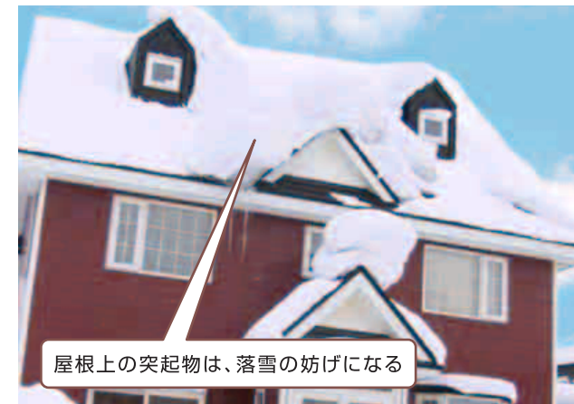
■写真:2 複雑な屋根形状での落雪障害
