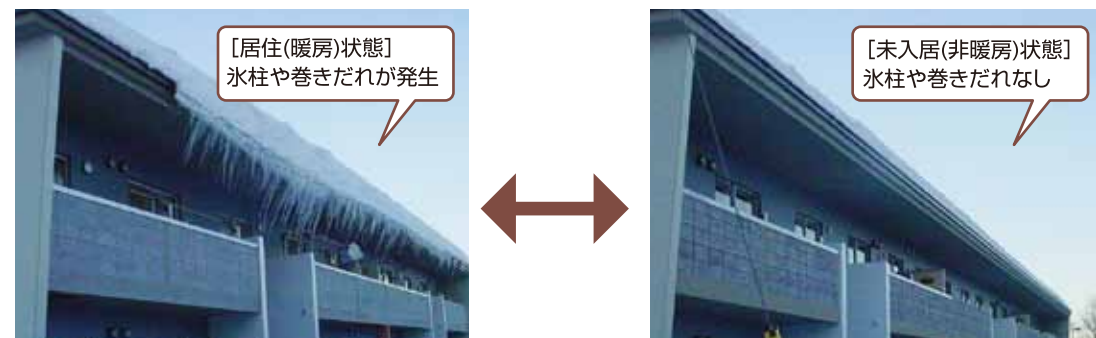
■写真:7 居住状態の雪氷障害と未入居状態の雪氷障害のちがい
