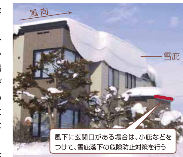
■写真:9 建物の風下側に発生した雪庇
