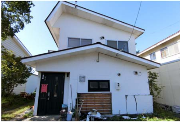
写真 5.3.30 応急危険度判定の結果が“危険”のモルタル外壁の専用住宅
