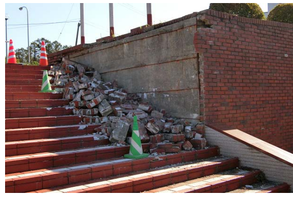
写真 5.3.6 早来町民センター庁舎南側の擁壁の仕上煉瓦の崩壊
