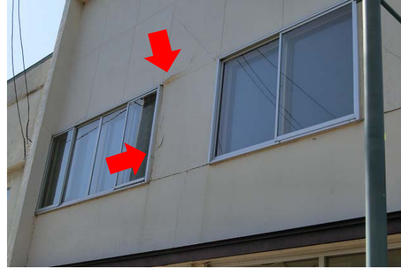
写真 5.3.24 写真 5.3.23 の壁面のひび割れ
