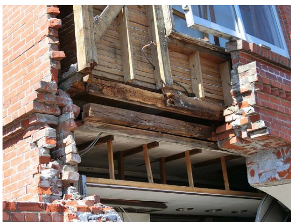
写真 5.3.13 写真 5.3.11 の露出した躯体の腐朽・蟻害
