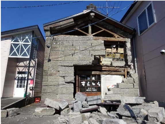
写真 5.3.17 比較的古い組積造の壁の崩落
