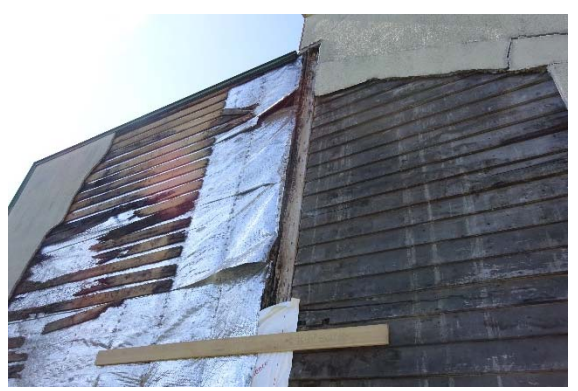
写真 5.3.22 写真 5.3.21 の壁面(柱・壁の腐朽)
