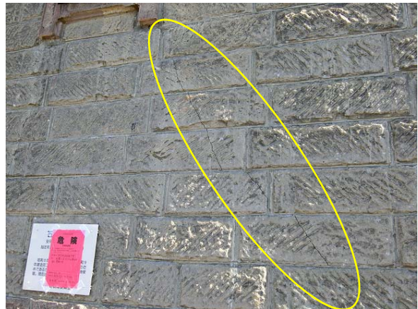
写真 5.3.20 写真 5.3.19 前面のせん断ひび割れ
