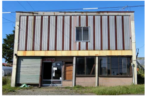
写真 5.3.38 残留変形が見られる店舗併用住宅
