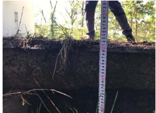
写真 5.2.8 旧小学校の校舎 A の北側の地割れ
