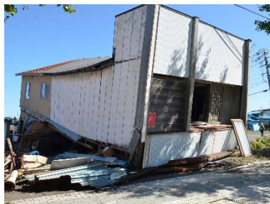
(b) 2階が東側へ倒れた正面部分
