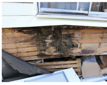
(e) 開口下部のモルタル下地板の腐朽
