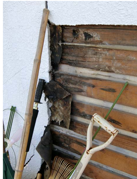
写真 5.3.32 写真 5.3.30 の外壁モルタルの剥落とその下地の腐朽
