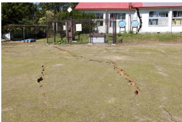
写真 5.2.7 旧小学校の校舎 A 南側の地割れ
