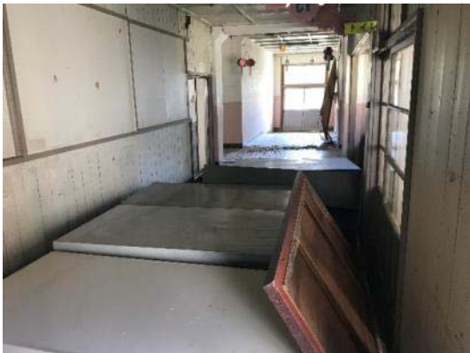
(a) 渡り廊下内部の家具等の転倒
