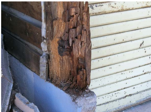
写真 5.3.26 写真 5.3.25 の柱脚の激しい腐朽
