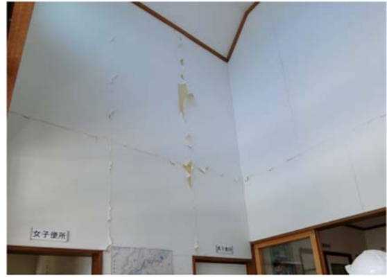
(b) 内部仕上材の損傷
