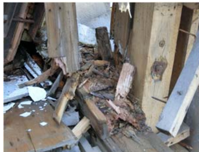
(e) 柱脚部の腐朽
