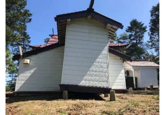
写真 5.2.12 寺社建築 C 西側の破壊状況
