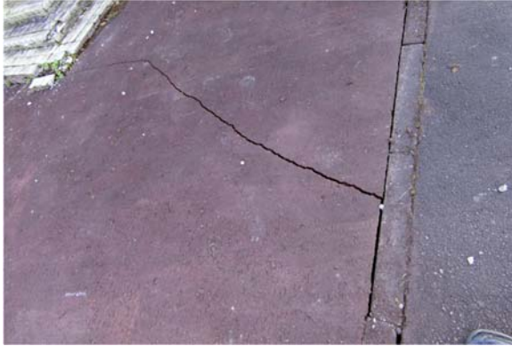
写真 5.3.5 地震計付近の舗装のひび割れ
