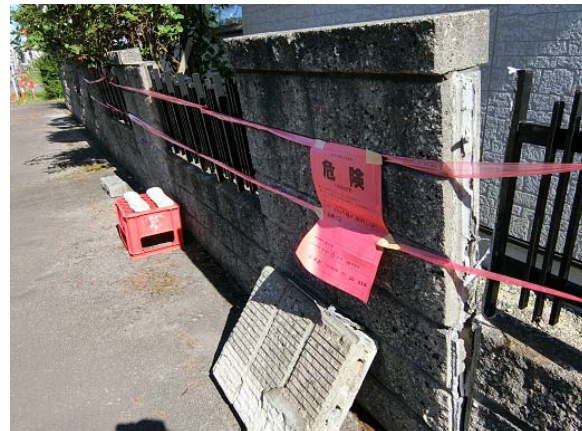
写真 5.3.29 写真 5.3.28 に附属し、傾斜したブロック塀
