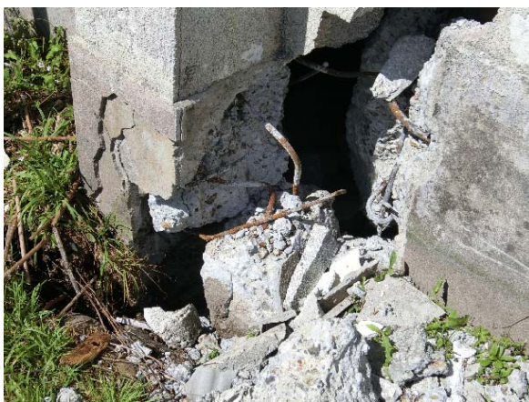
(c) 破壊部分の詳細 (底部)
