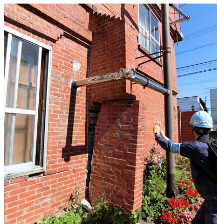
写真 5.3.14 写真 5.3.11 の破損した控え壁のような部分
