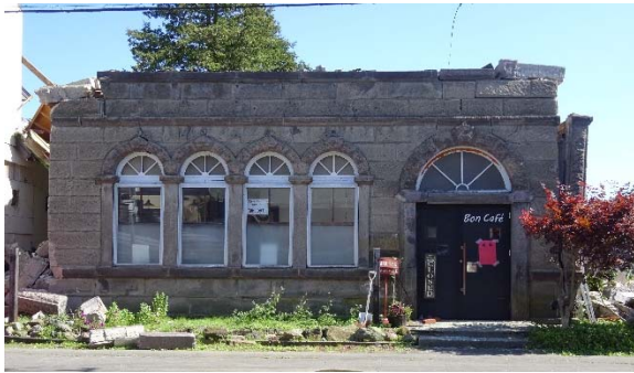
写真 5.3.15 比較的古い組積造の2層の崩壊
