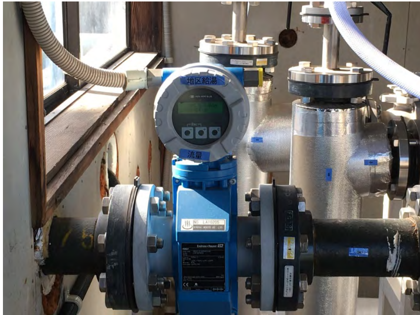
弟子屈町が設置した流量計
