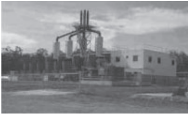
UCG生成ガス発電所(5MW)
