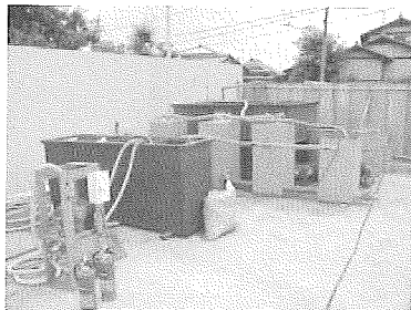
地下水揚水+土壌ガス吸引の装置組合
