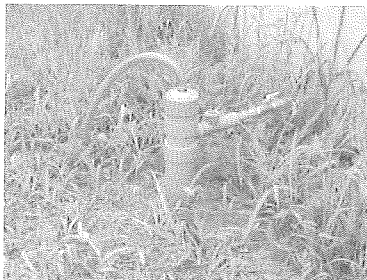
地下水揚水+ガス吸引井戸
