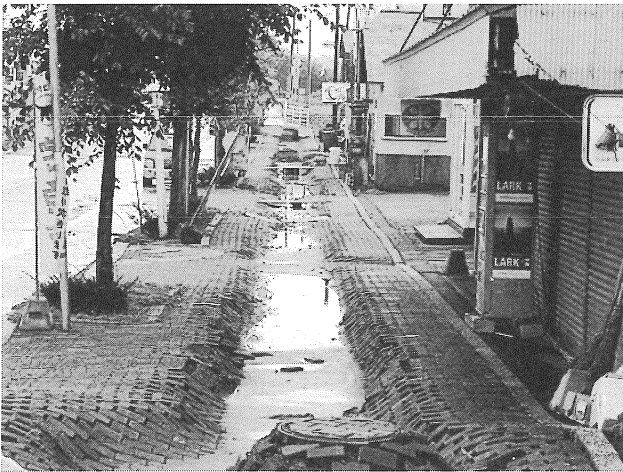
写真24 埋め戻し土が沈下する。マンホールの周囲 からは細粒砂が噴出(豊頃駅前)
