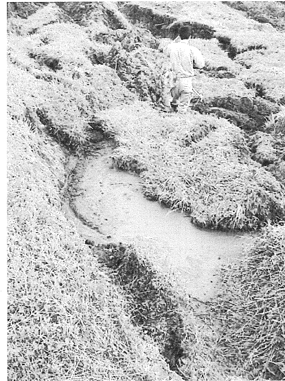
写真19 頭部亀裂から噴き出した細粒砂
