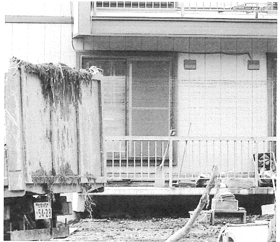
写真1 建物の壁に残る高さ3mの冠水痕跡
