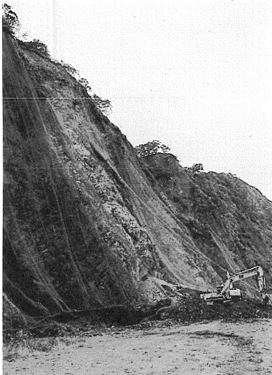
写真30 黄金道路ほしば覆道上の岩石崩壊 風化したホルンフェルスからなる。
