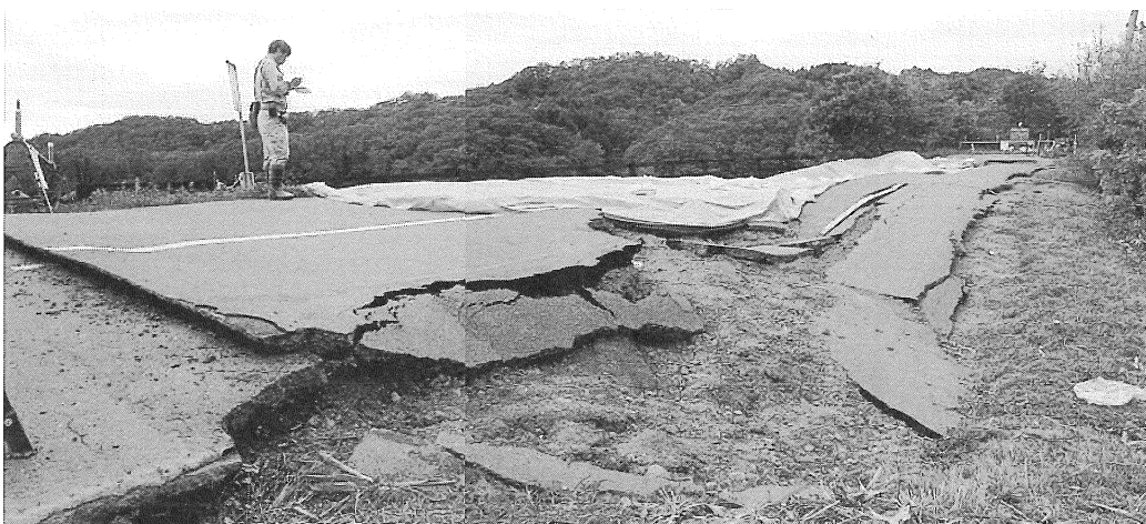
写真21 丘陵尾根部に盛土された道路の崩壊 写真左部のアスファルトが乗り上げた方向が 震源方向とほぼ一致する.
