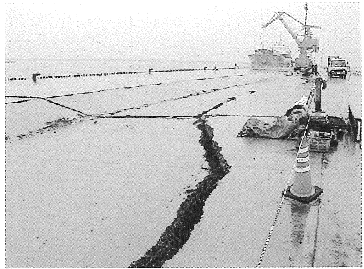
写真29 釧路西港第4埠頭で開口亀裂が生じる 地盤は海側(写真右)に側方移動した
