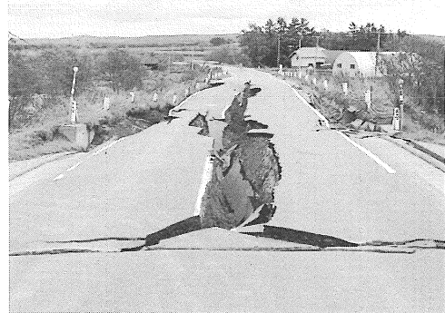
写真20 愛牛橋取り付け道路の路盤崩壊
