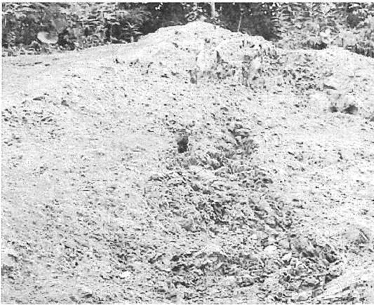
写真14 新和对岸崩壊の側壁に現れた パイピングホール
