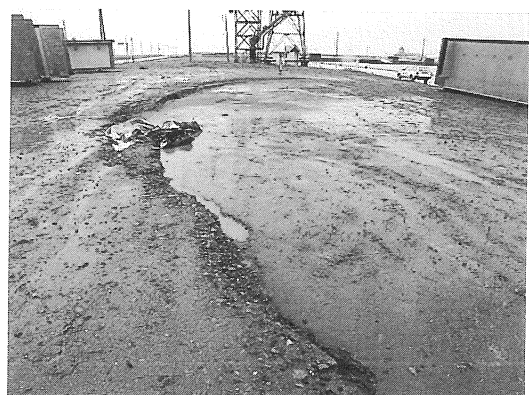
写真27 十勝港第3埠頭で段差の亀裂から噴砂が 生じる。右側岸壁へ側方流動する。
