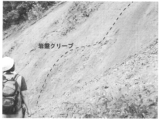
写真13 新和对岸崩壊の側壁に露出した クリープ構造
