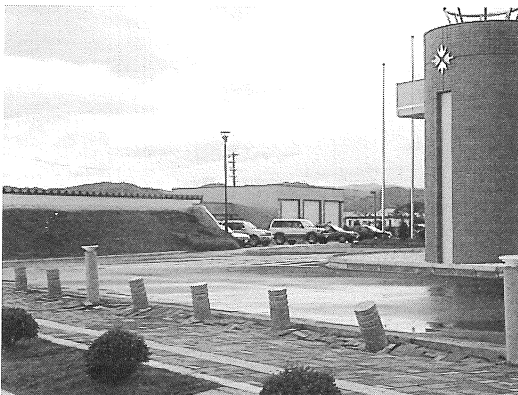
写真26 新冠町役場では周辺の地盤が沈下し、 建物が相対的に抜け上がる。
