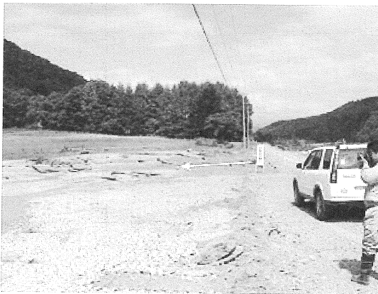
写真2 アスファルトが剥ぎ取られ 左手前へ流される
