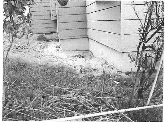
写真23 写真22の住宅基礎部分から噴砂が発生
