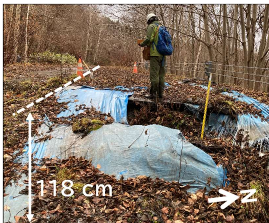
図 3 SAR で捉えた変動域で確認された道路面の変状
