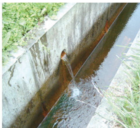
水田下部にある暗渠排水
