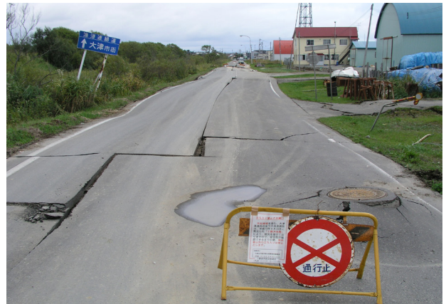
写真 十勝管内豊頃町で発生した液状化の被害状況（平成15年十勝沖地震）。液状化により道路が波打つように変形し、通行できなくなっています。
