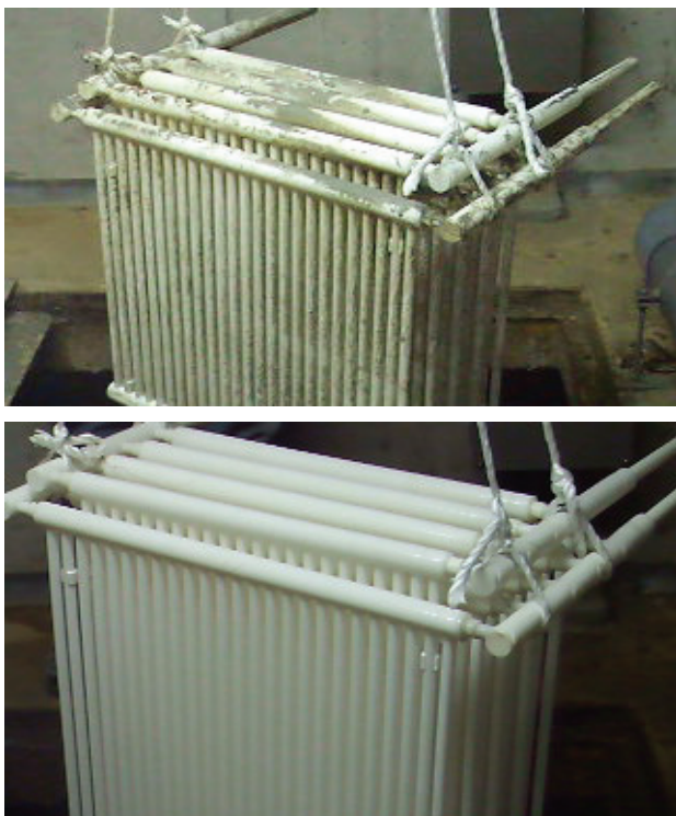
図4 洗浄前後の熱交換器の外観（上：洗浄前 下：洗浄後）
