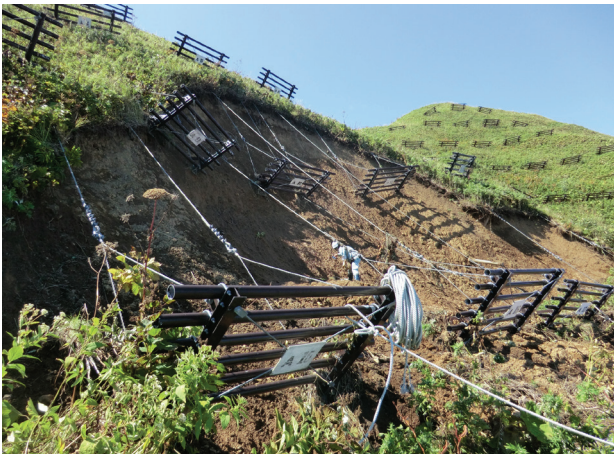
写真 3 斜面中腹でスプーン状にえぐられた崖崩れ発生源
