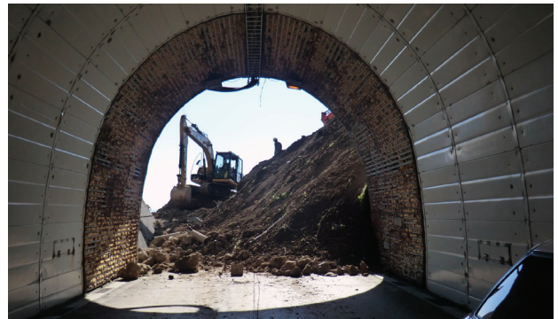
写真 5 土砂によりふさがれた道道元地香深線のトンネル出口
