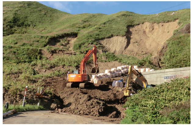
写真 4 元地地区を孤立させた桃岩トンネル西側の崖崩れ
