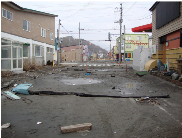
写真3 幌泉川の暗渠部の持ち上がりによる道路亀裂 （えりも町本町）
