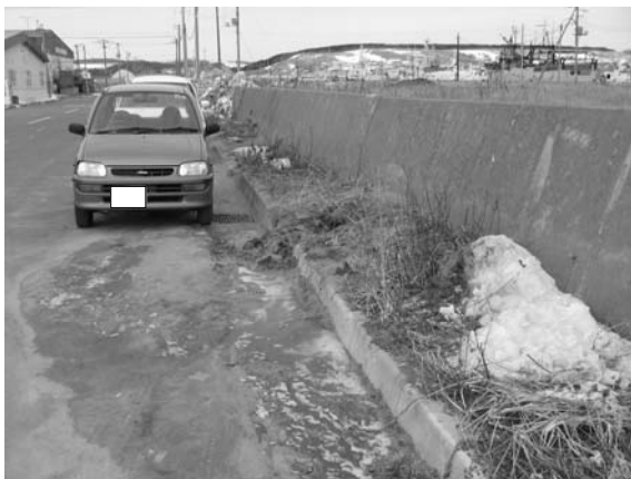
防潮堤沿いの噴砂列（花咲港西浜埠頭）
