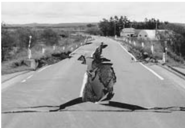
橋の取り付け道路で発生した路盤崩壊。盛土が大規模に側方流動し、アスファルトに開口亀裂が発生している。（浦幌町愛牛）
