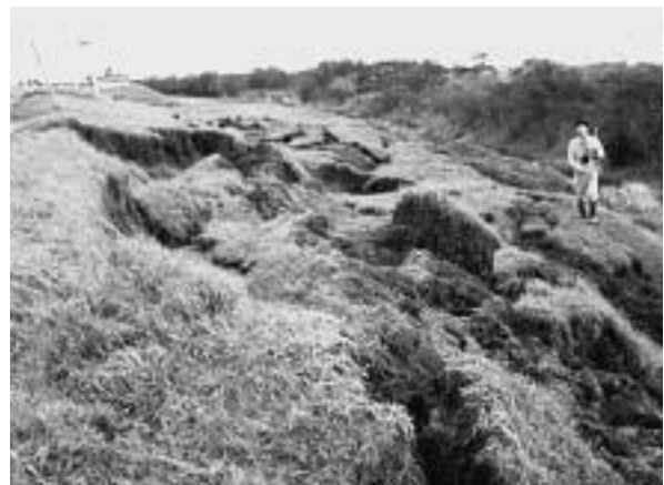
十勝川西岸の堤防堤体の崩壊。堤防を形成する盛土が側方流動した。移動体の内部では各所で液状化による噴砂が認められる。（豊頃町大津）
