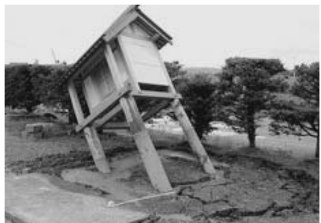
神社で発生した液状化（浦幌町愛牛）
