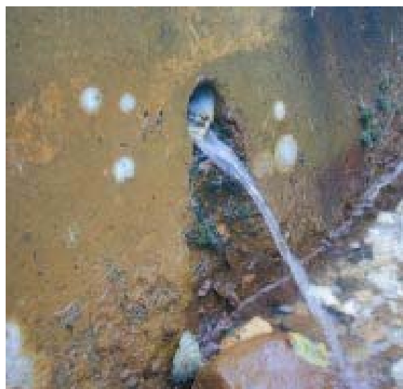
写真 酸性水によって溶けたコンクリート擁壁
