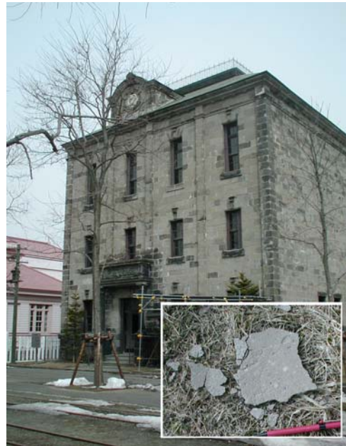
写真 旧小樽新聞社と剥落した外壁（囲み内）
