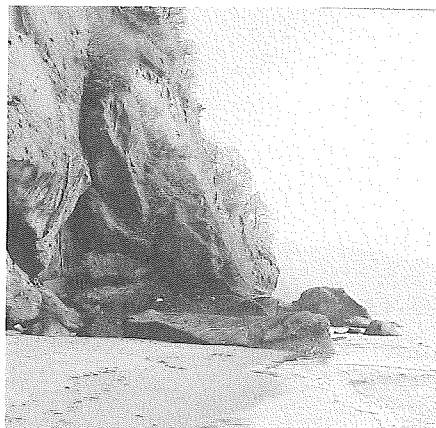
写真2 豊浦海岸の岩盤崩落
