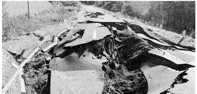
別海町北12号線(町道)の盛土崩壊
