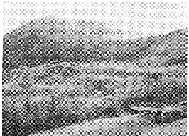
写真4 崩壊した盛土斜面
