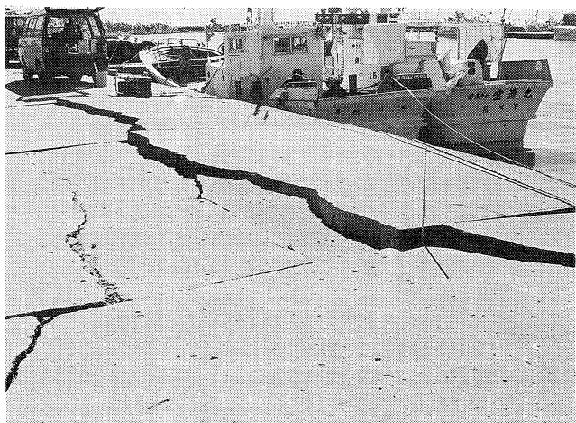
写真6 花咲港における岸壁の亀裂と沈下
