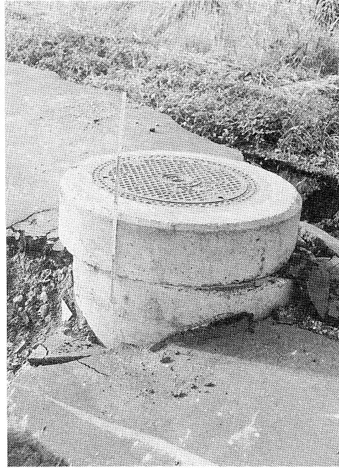
写真3 マンホールの変動
