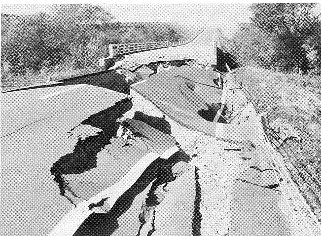
写真2 破壊されたアスファルト路盤
