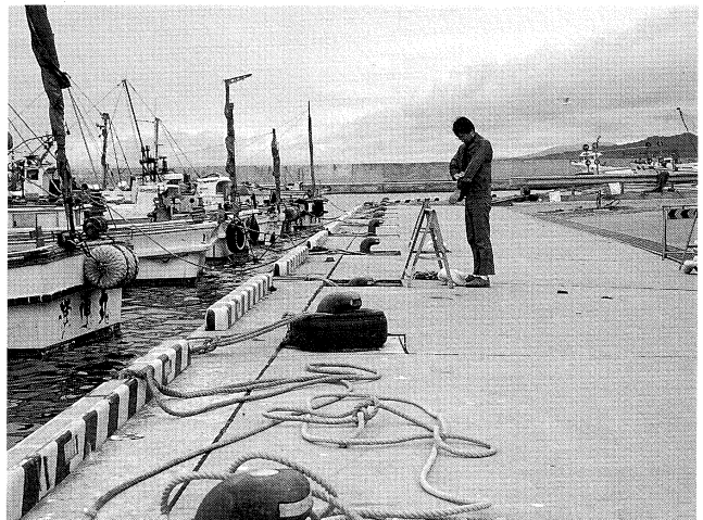
写真1 液状化により沈下したピット（長万部港）
