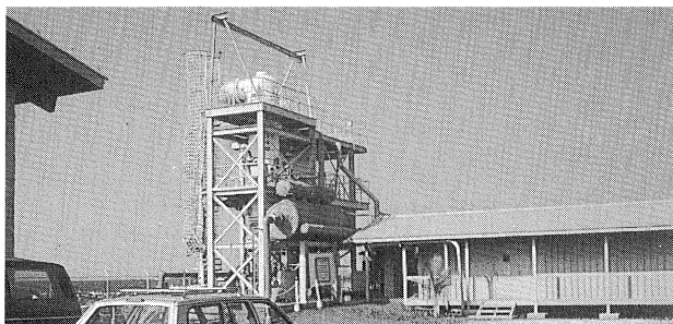
NELHA(ハワイ州)による温度差発電実験装置
