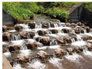
落差工に設置された魚道
