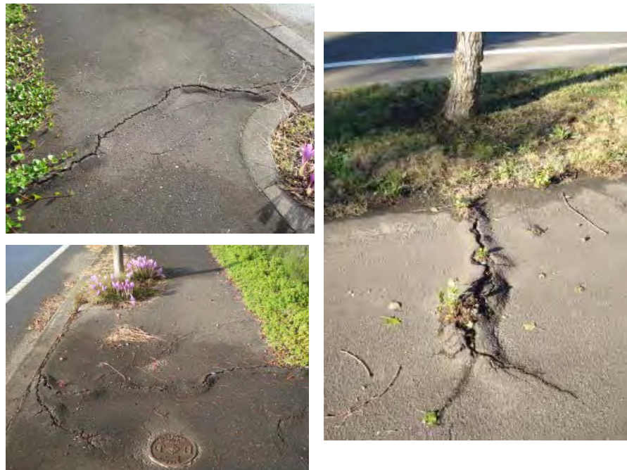
写真－Ⅶ－4 歩道を持ち上げて広がる街路樹の根系
