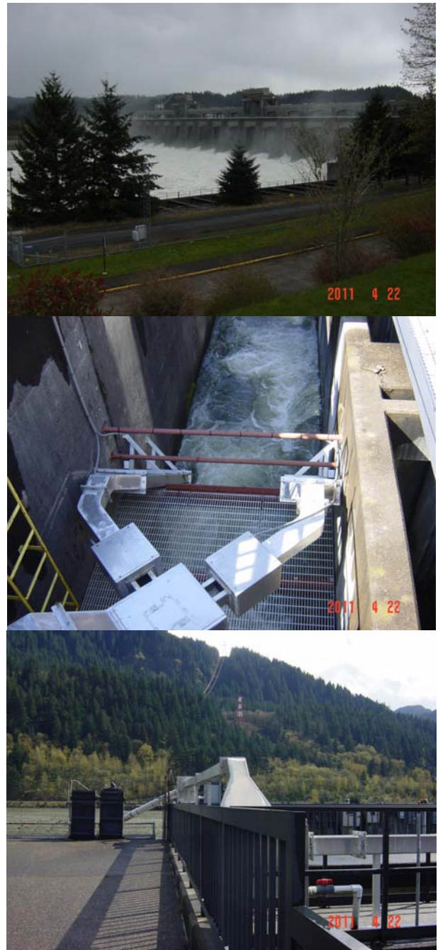
写真4 ボナビルダムに設置されたヤツメウナギ専用の魚道 1 番上の写真はボナビルダムで発電タービンを通過した水が排水されている。2 番目の写真はサケ科魚類などが利用する魚道で、アルミの管がヤツメウナギの魚道である。内部は格子状になっており、ヤツメウナギは体をくねらせて遡上する。3 番目の写真は、魚道上部であり、アルミ管の奥を親魚が通過することで、ダム上流へ遡上したことになる。
