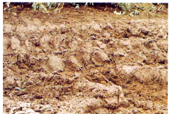
写真 - 3 機械走行によって泥寧化した路面
