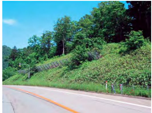
写真-3 周辺植生(ササ)が被覆した法面
