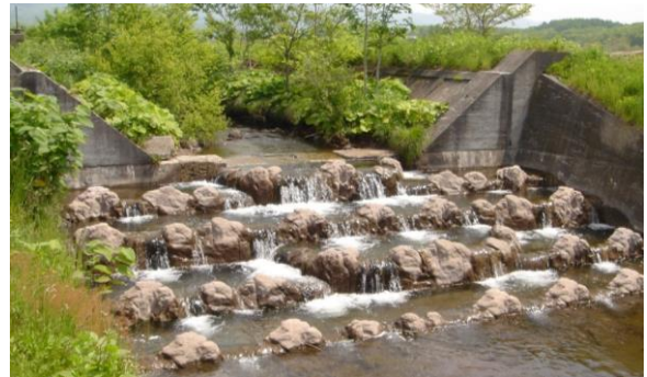
図 1 白井川の落差工に設置された魚道
