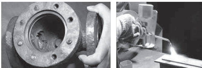
(a) 損傷した弁箱 (b) 溶射皮膜補修用トーチ
