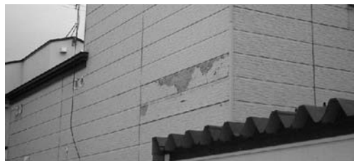
写真2 サイディングの凍害（通気層の不備）
