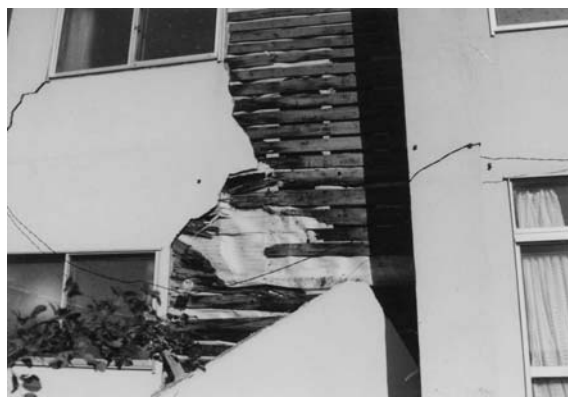
写真5 モルタル外装材の被害例
