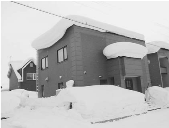
写真1 住宅の雪庇(滝川市)
