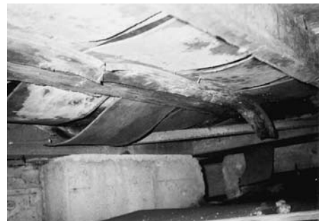
写真2 床下構造材等の劣化
