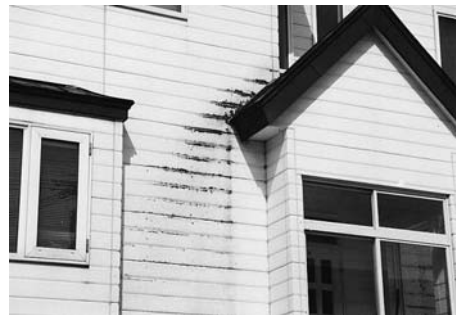
写真1 外装材の劣化
