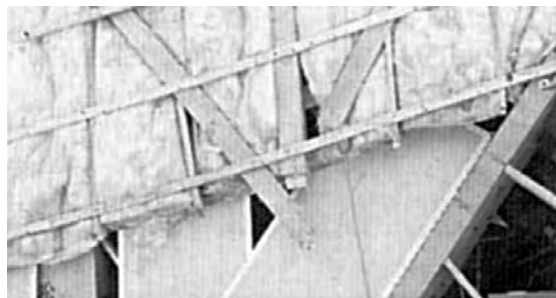
写真3 接合部の緊結不足による被害例
