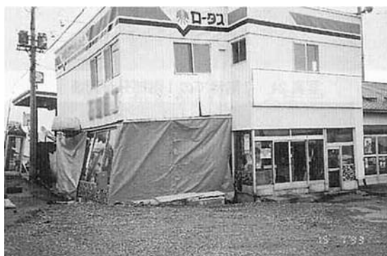
写真2 壁量の不足・偏心による被害例
