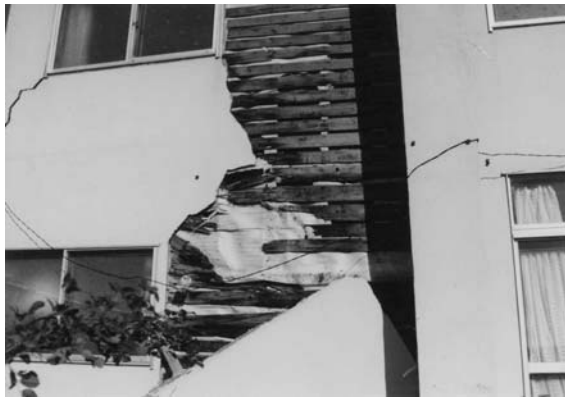
写真5 モルタル外装材の被害例
