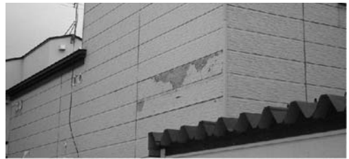
写真2 サイディングの凍害（通気層の不備）
