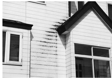
写真1 外装材の劣化
