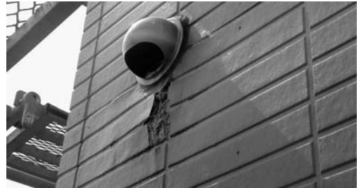
写真1 サイディングの凍害（排気口からの結露水の漏れ）
