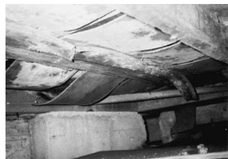
写真2 床下構造材等の劣化
