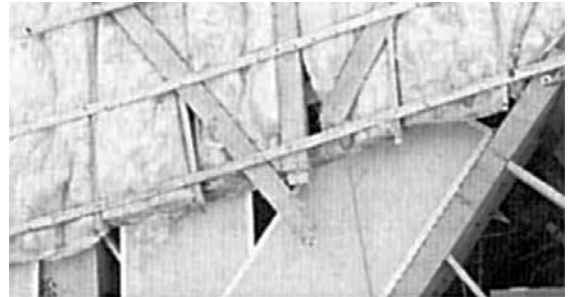
写真3 接合部の緊結不足による被害例
