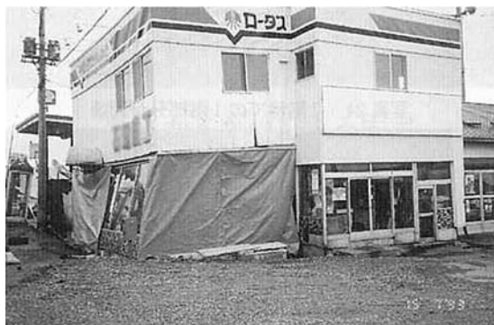
写真2 壁量の不足・偏心による被害例
