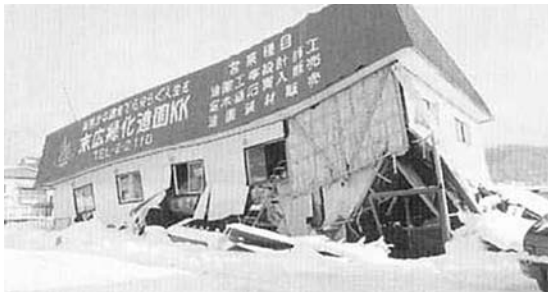
写真1 壁量不足と接合部の緊結不足による被害例
