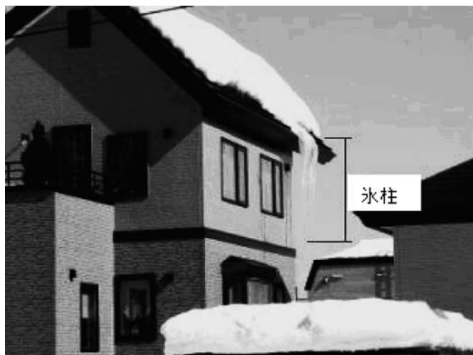
写真1 断熱・換気不足に起因する氷柱の形成
