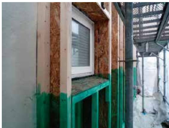
写真18 壁ふかし窓周り
