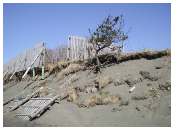
写真2 高潮によって倒壊した防風柵 支柱や根が浮いている (2008年4月15日)。
