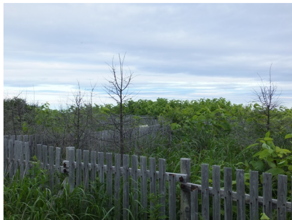
写真4 塩害で枯死したグイマツ 波が流れ込んだ痕跡もあった(2012年7月20日)。
